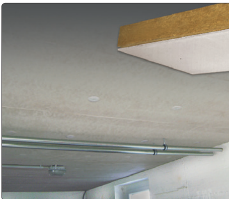
Im Kellerdecken-Dämmelement KDE-22 von Isolith wurde der neue schlanke Dämmstoff Austrotherm Resolution verarbeitet.
